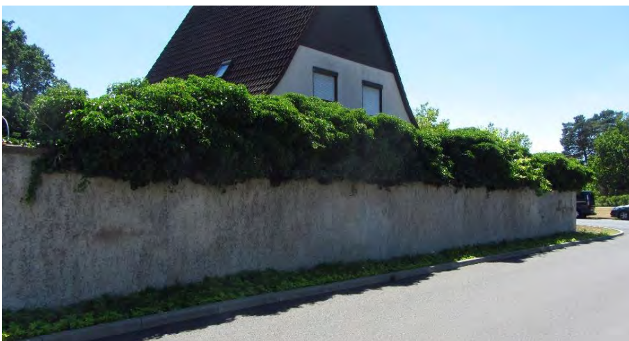
Abbildungen 1+2: Mauer an den Grundstücken Bernauer Straße 128 - 132, Blick von Osten (oben), Mauerbewuchs mit Efeu (unten)
